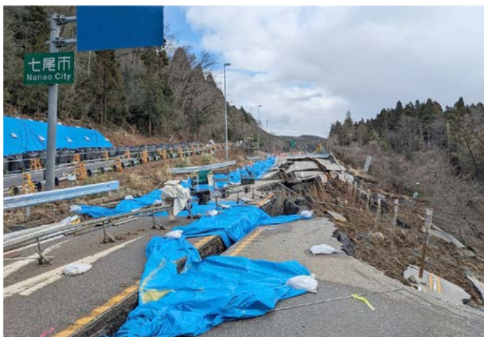
[写真3]能登半島地震で崩落した道路
