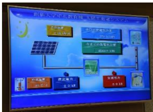
中央教育棟：太陽光パネル監視システム
