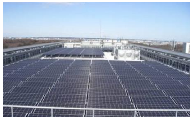
中央教育棟屋上の太陽光パネル
